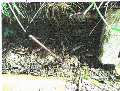
vyčnívající zkorodované kulatiny trčí do prostoru
